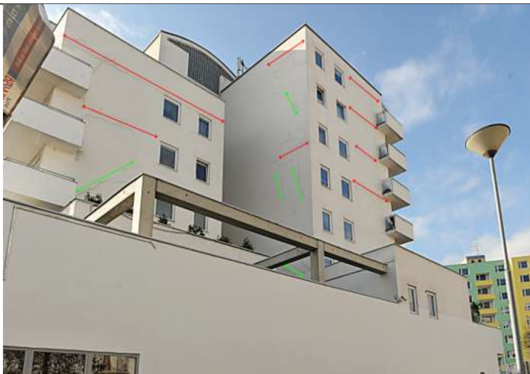
Foto č.6: Severní fasáda. Barevné vyznačení nejvýraznějších trhlin na povrchu fasádního pláště. Zdroj: Fotodokumentace z místního šetření
