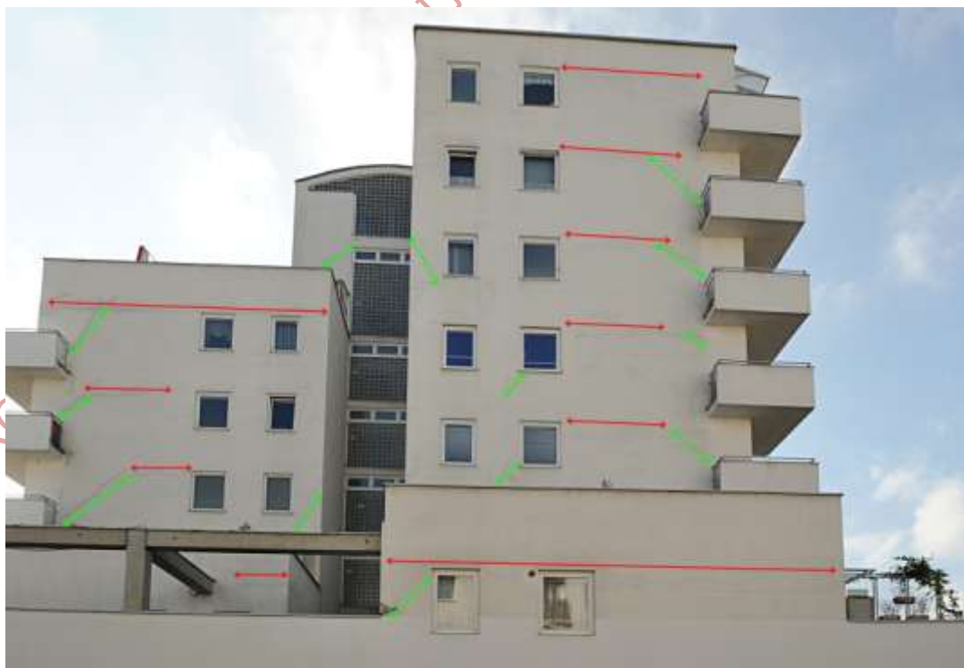
Foto č.5: Severní fasáda. Barevné vyznačení nejvýraznějších trhlin na povrchu fasádního pláště. Zdroj: Fotodokumentace z místního šetření
