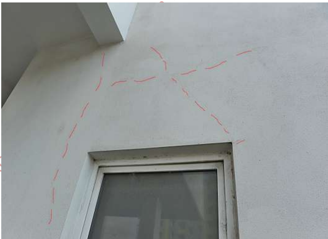
Foto č.9: Západní fasáda. Plocha fasády je protkaná sítí nepravidelných vlásečnicových trhlin Zdroj: Fotodokumentace z místního šetření
