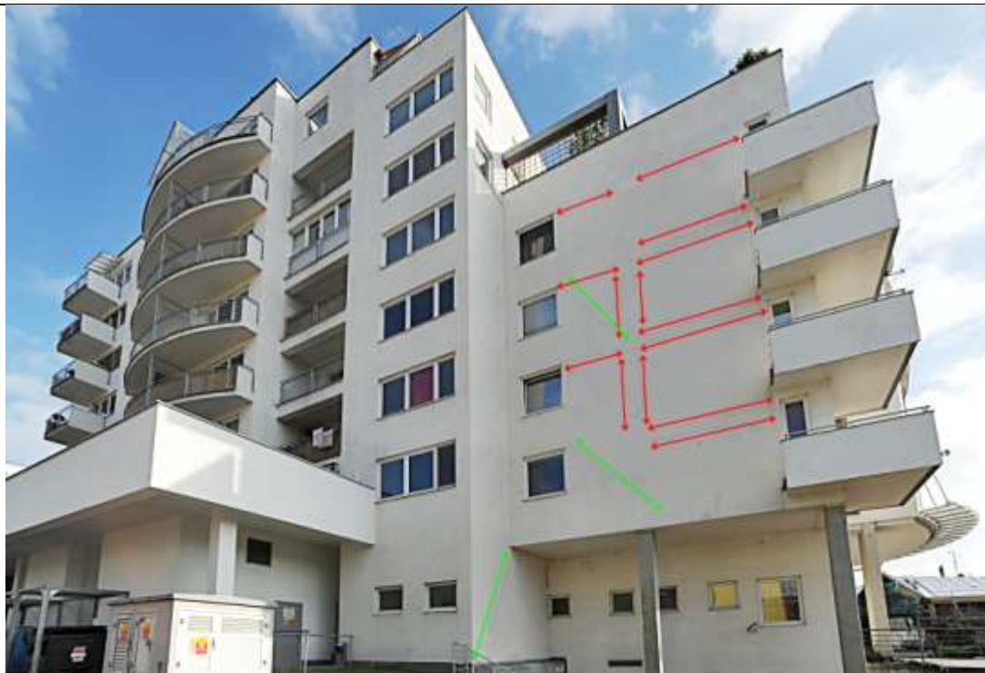
Foto č.4: Západní fasáda. Barevné vyznačení nejvýraznějších trhlin na povrchu fasádního pláště. Červeně vyznačeny dilatační trhliny v místě přechodu nesterjnorodých podkladů fasádní omítky (desky Lignopor x tvárnice Ytong), zeleně vyznačeny trhliny způsobené přitížením výplňového zdiva díky průhybu obvodových horizontálních železobetonových ztužidel v úrovni stropní konstrukce každého podlaží. Zdroj: Fotodokumentace z místního šetření
