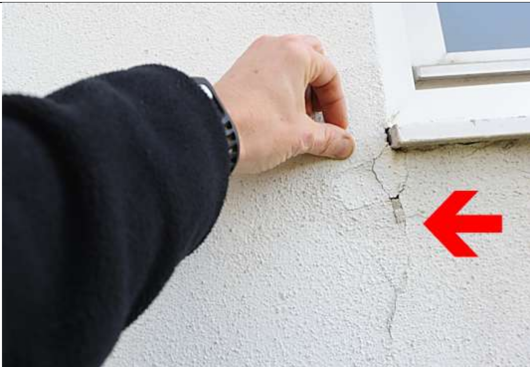
Foto č.8: Západní fasáda. Detail fasády u okenního parapetu v 1.NP s projevem statických trhlin způsobených přetížením výplňového fasádního zdiva průhybem obvodových železobetonových ztužidel Zdroj: Fotodokumentace z místního šetření
