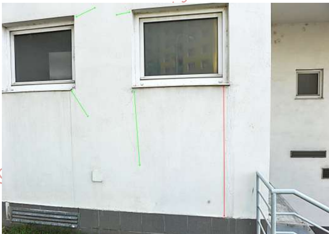
Foto č.7: Západní fasáda. Okenní otvory v 1.NP s projevem statických trhlin způsobených přetížením výplňového fasádního zdiva průhybem obvodových železobetonových ztužidel – vyznačeny zeleně. Červeně vyznačeny dilatační trhliny v místě přechodu nesterjnorodých podkladů fasádní omítky (desky Lignopor x tvárnice Ytong) Zdroj: Fotodokumentace z místního šetření
